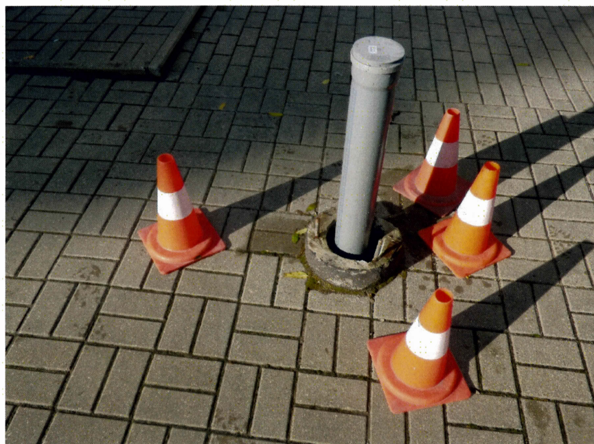
Uszkodzony fundament pod słup oświetleniowy
