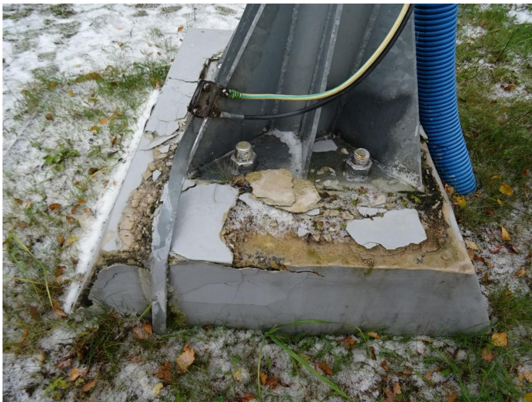
Fot. 21. Destrukcja mrozowa fundamentu
