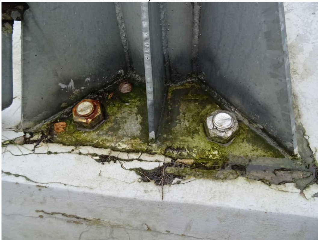
Fot. 24. Destrukcja mrozowa fundamentu
