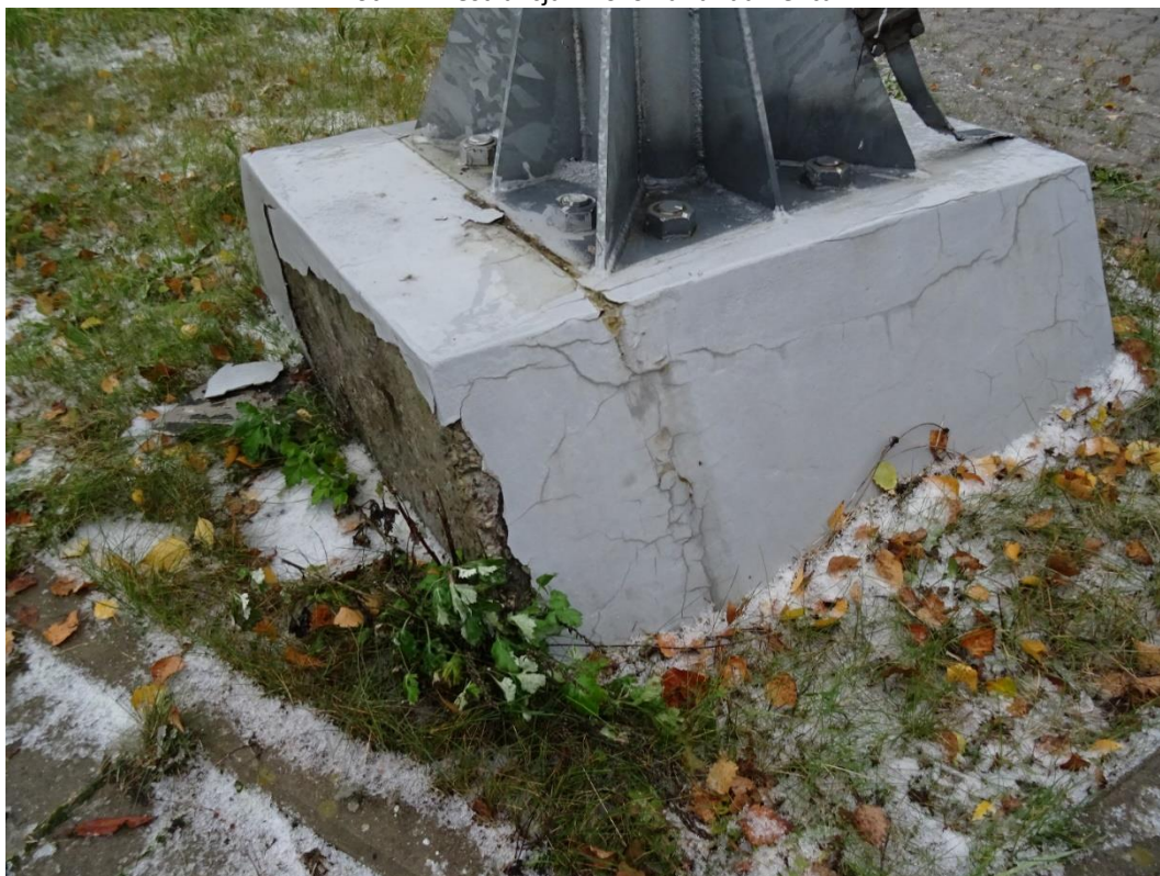
Fot. 22. Destrukcja mrozowa fundamentu
