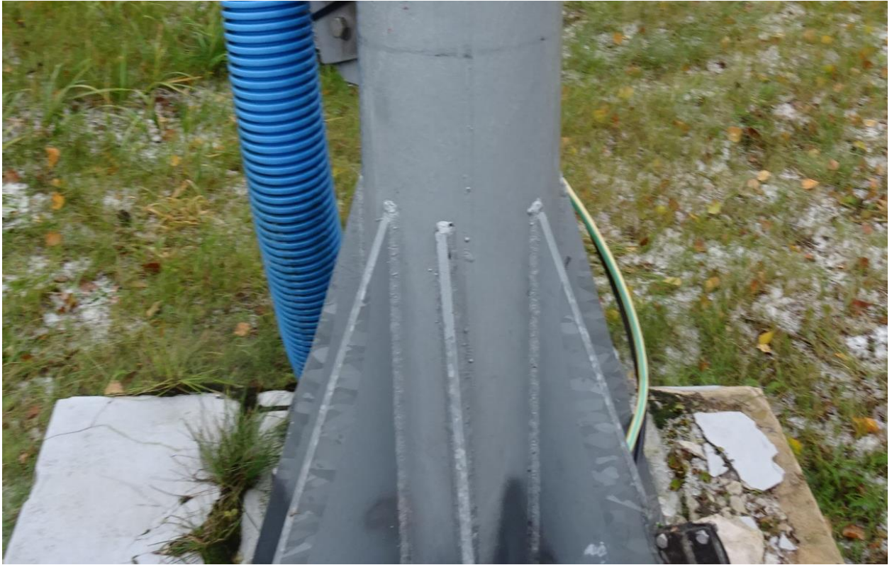
Fot. 19. Krzywo przymocowane blachy wzmacniające węzeł
