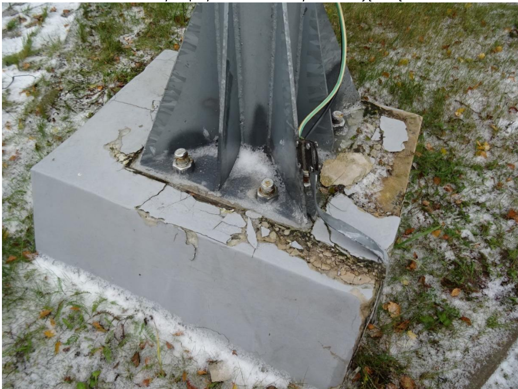
Fot. 20. Destrukcja mrozowa fundamentu
