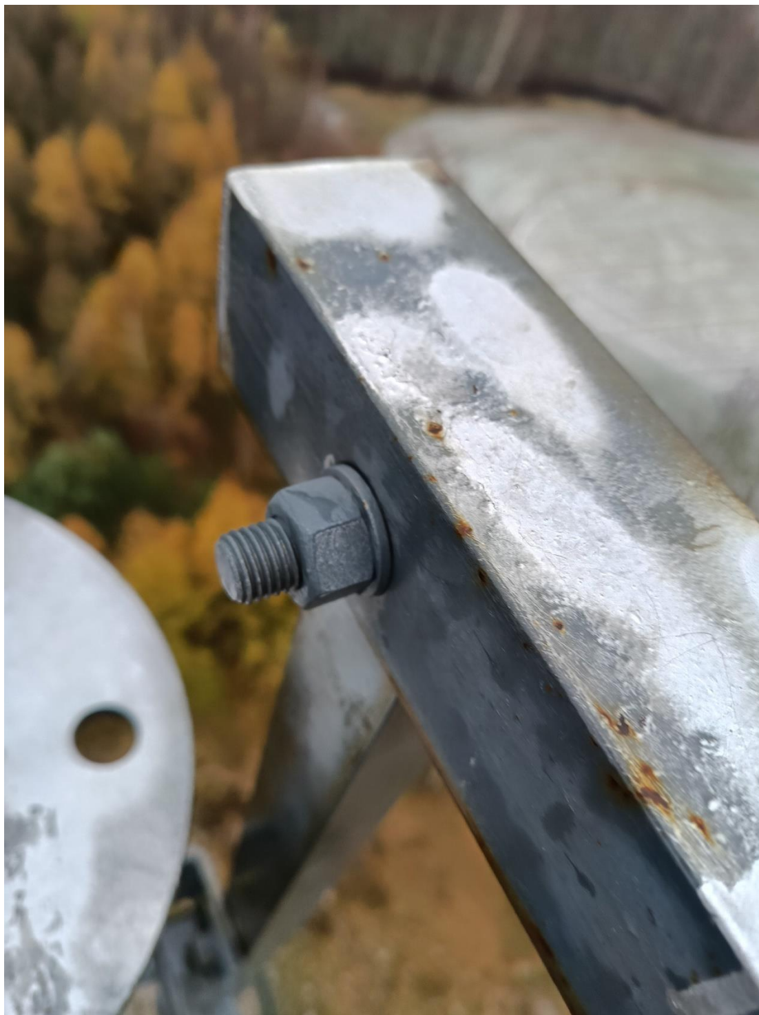
Fot. 6. Korozja, brak podkładek w połączeniu pomocniczym
