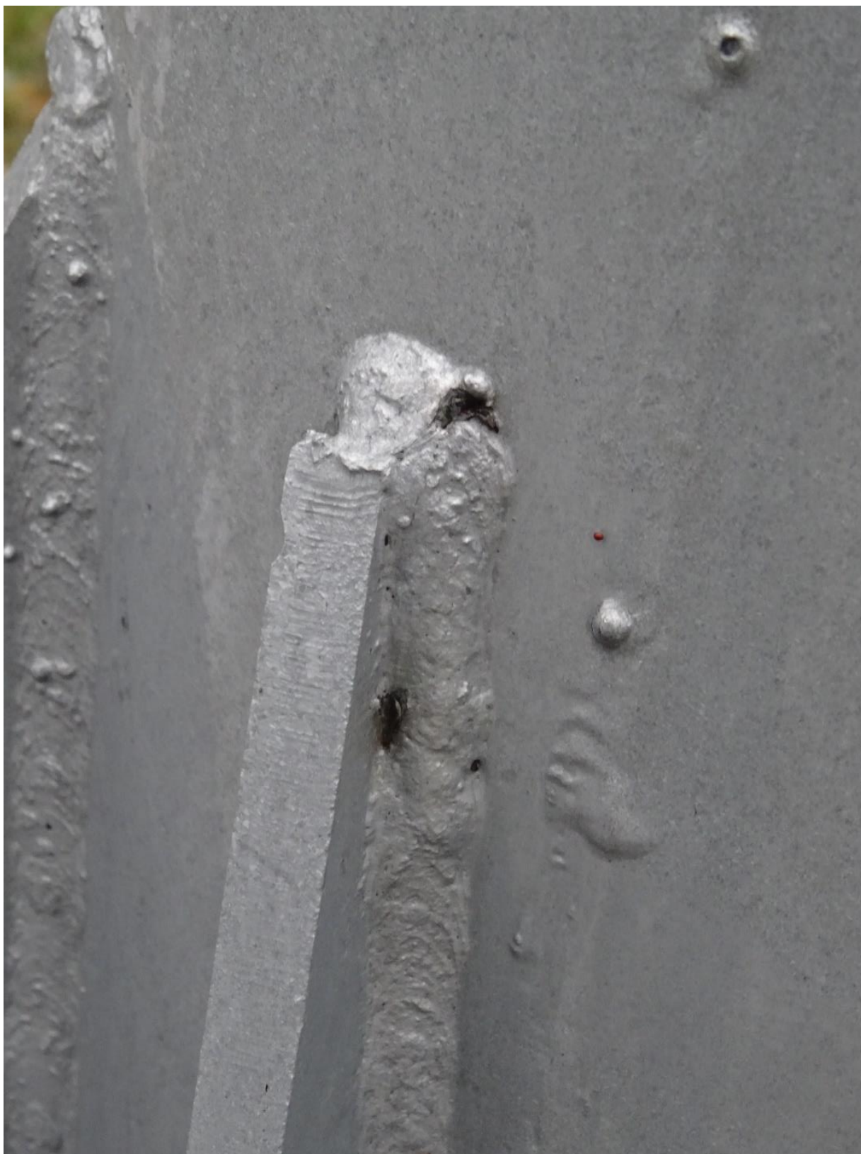
Fot. 15. Wady połączeń spawanych
