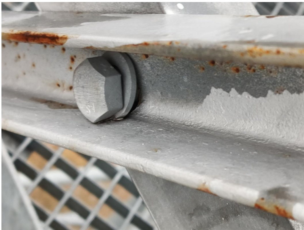
Fot. 7. Nieprawidłowo dobrane złącze śrubowe
