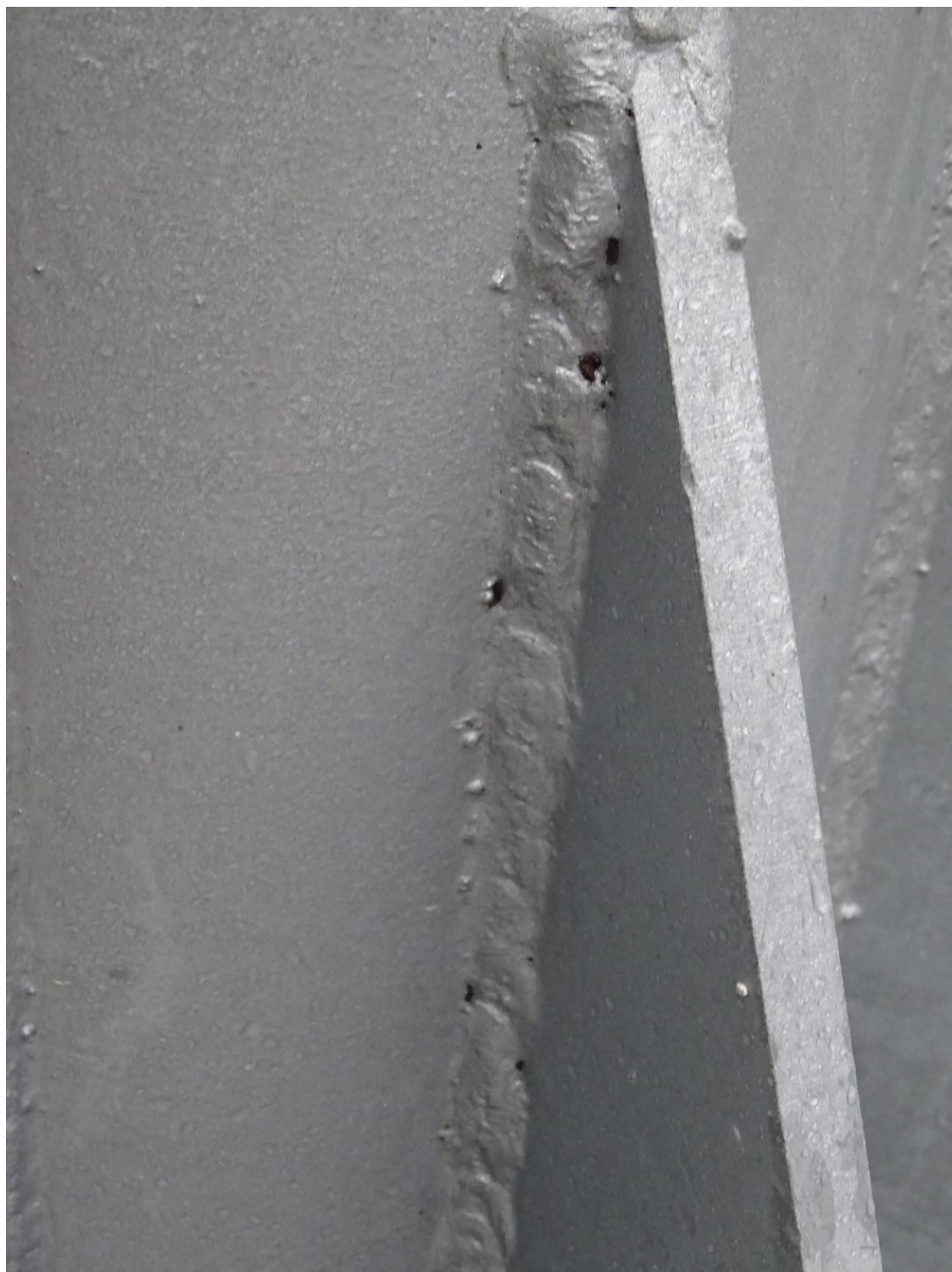
Fot. 16. Wady połączeń spawanych
