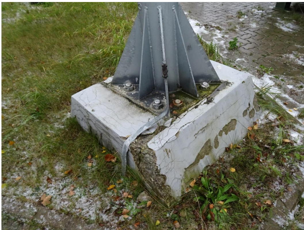
Fot. 23. Destrukcja mrozowa fundamentu
