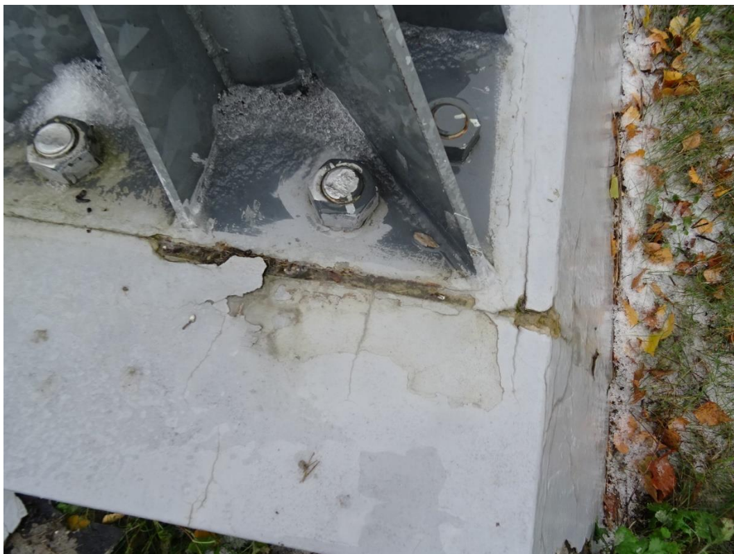
Fot. 25. Destrukcja mrozowa fundamentu
