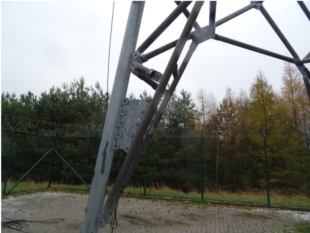
Fot. 3. Skratowanie dolnej części krawężnika
