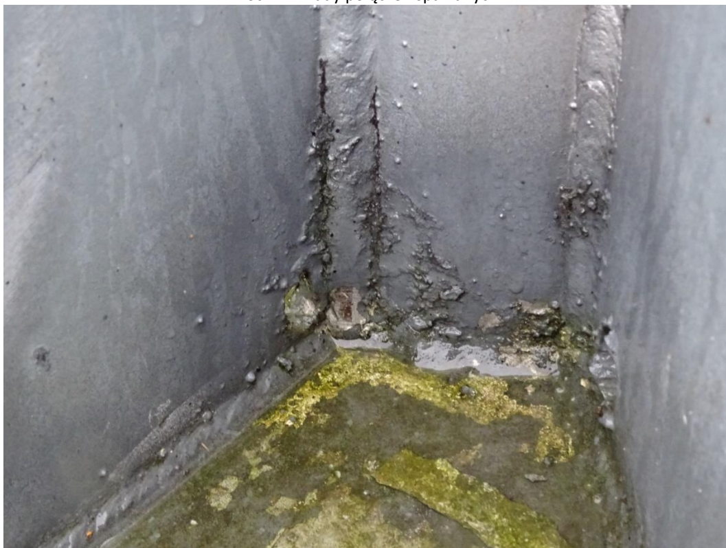
Fot. 18. Wady połączeń spawanych
