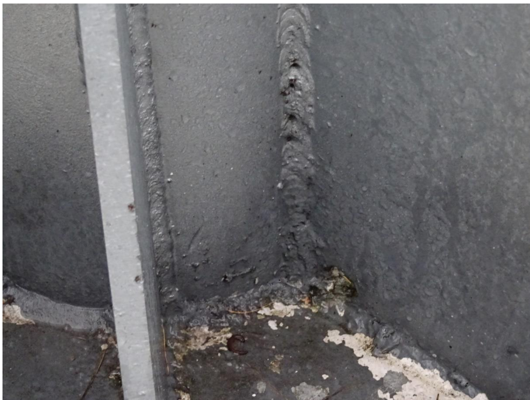
Fot. 17. Wady połączeń spawanych
