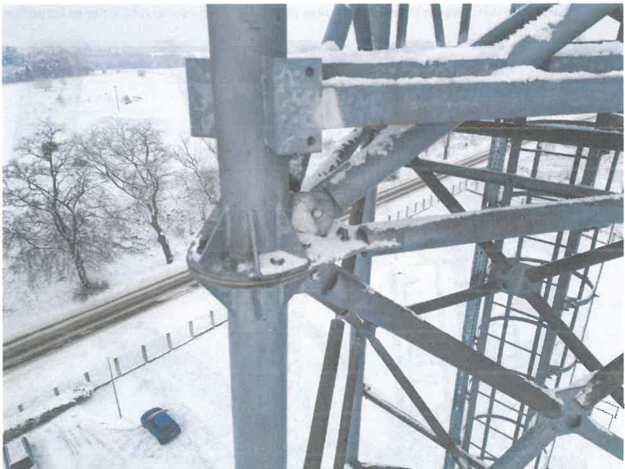
Fot. 11 Korozja łączników, zbyt krótkie śruby, brak podkładek sprężystych w połączeniach kątnierzowych segmentów
