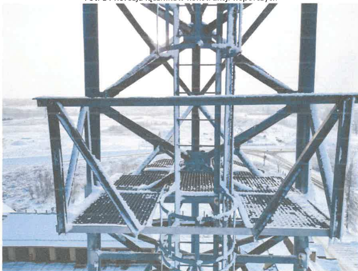
Fot. 15 Korozja łączników drabiny włazowej i podestów obsługowych
