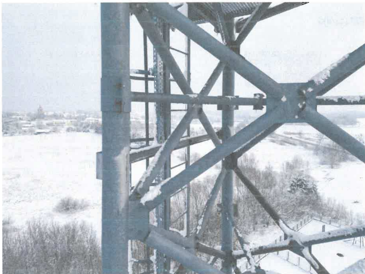
Fot. 14 Korozja łączników konstrukcji wsporczych
