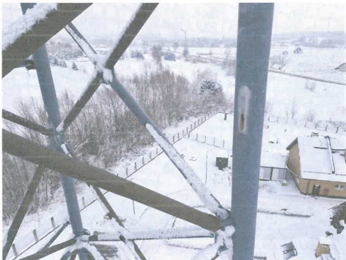
Fot. 12 Korozja wżerowa na krawężnikach oraz początki korozji powierzchniowej na krzyżulcach
