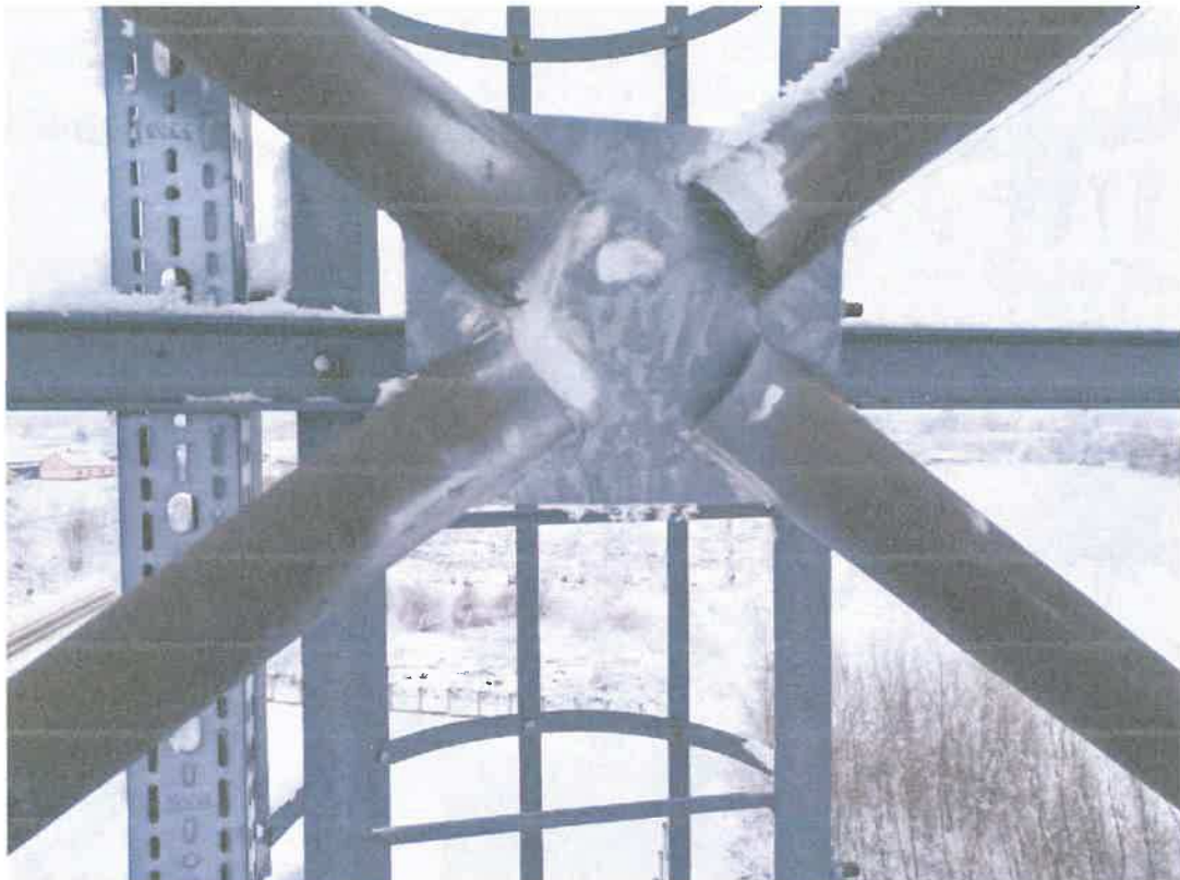
Fot. 9 Brak symetrii w połączeniach spawanych blach węzłowych z elementami wieży
