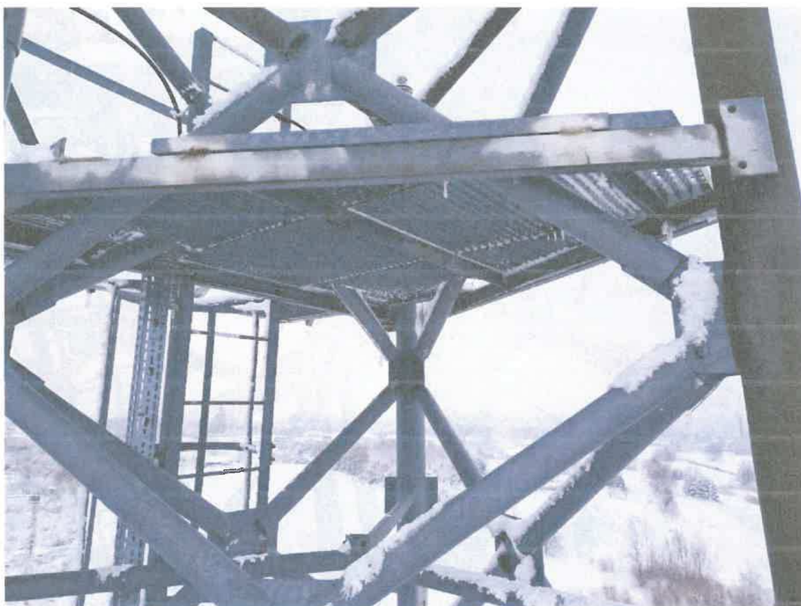
Fot. 13 Korozja wżerowa na elementach podestów obsługowych
