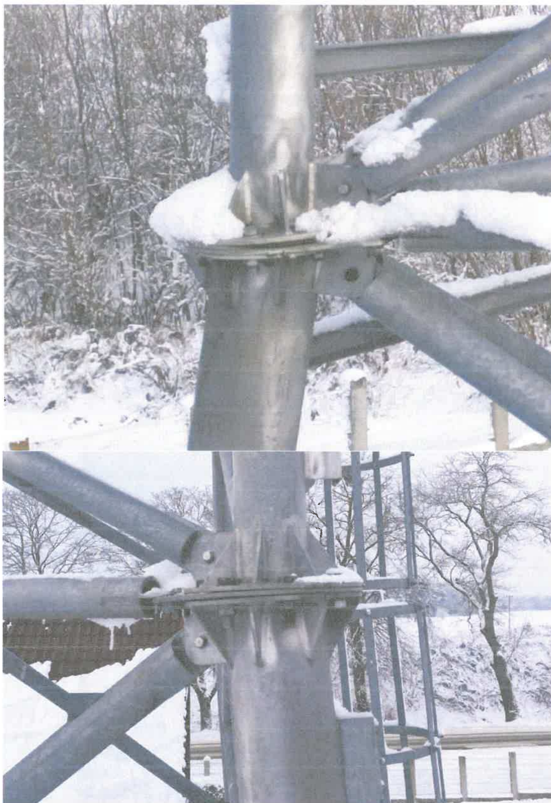
Fot. 4 i 5 Nieprawidłowe ułożenie flansz w stosunku do profilu krawężników w połączeniach kołnierzowych segmentów
