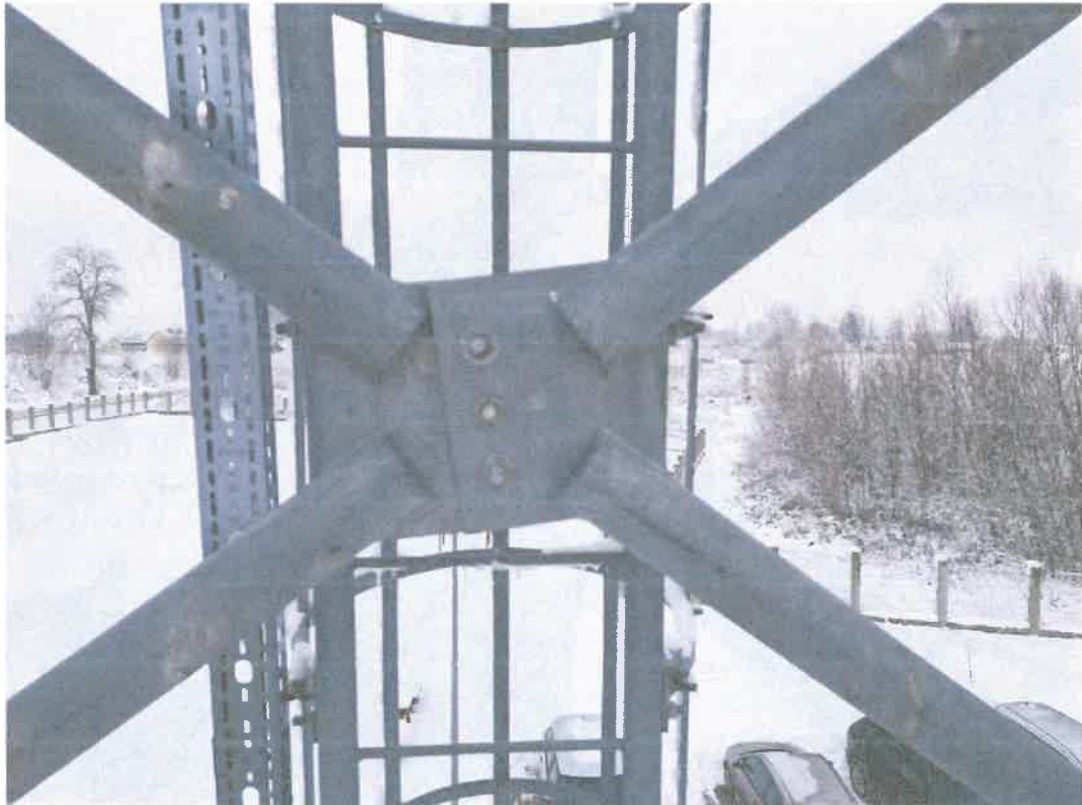
Fot. 8 Niesymetryczne połączenie elementów wysyłkowych skratowania
